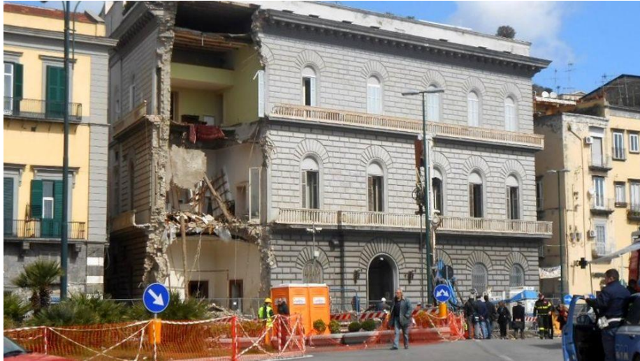
Palazzo Guevara di Bovino alla Riviera di Chiaia: l'ala crollata in séguito dei lavori della Linea 6 metropolitana
